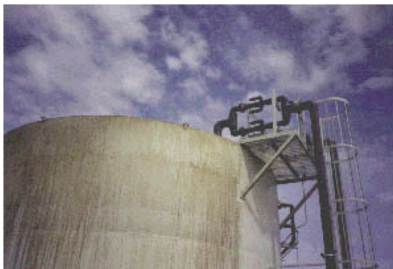
2 vues de la même installation
