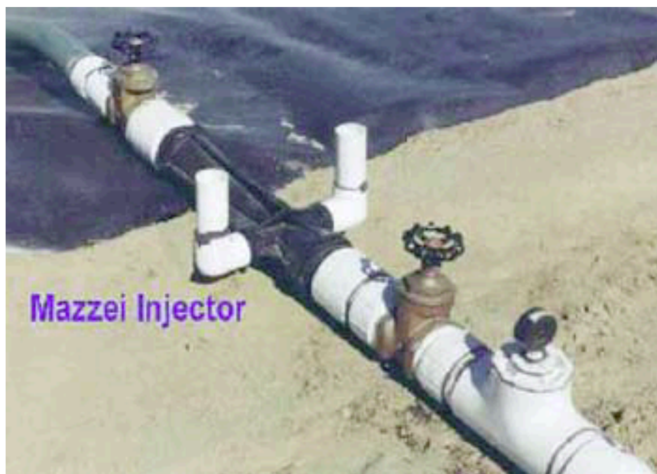
Vue d'un injecteur 4'' de l'installation de la photo précédente
