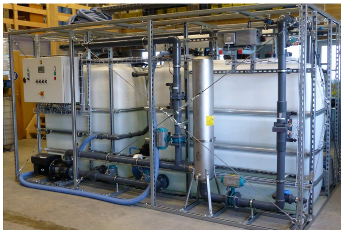
Installation d'UF 10 m 3 /h montées sur rack. Préfiltre inox 100 µm, 7 x 40"
